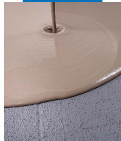
Aplicação de barramento autonivelante sobre Eco Prim Grip Plus seco e aplicado sobre pavimento velho
